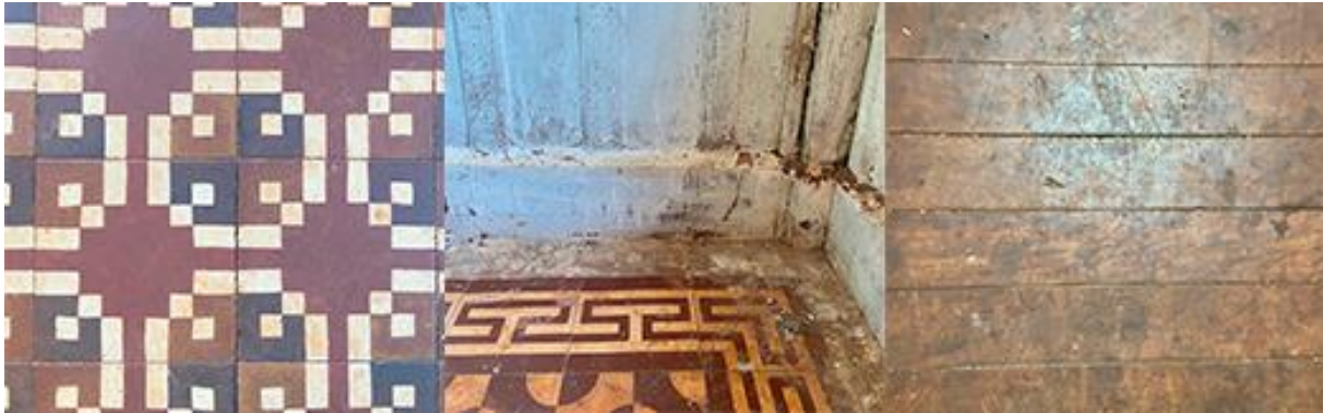
Figura 5: Piso em ladrilho hidráulico, junção piso em ladrilho com parede de madeira e piso de madeira.
